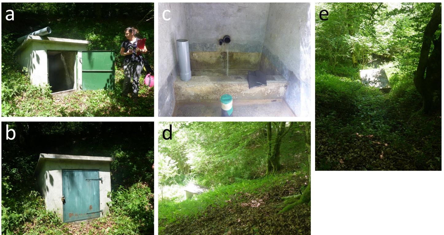
Figure 5 : Captage de Ganoux bas (a,b), intérieur du captage (c) et son environnement proche (d,e)
